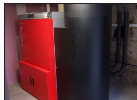
Nouvelle chaudière à granulés de bois
