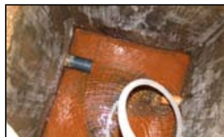
Regard nécessitant un nettoyage
